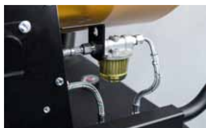
Il filtro gasolio è esterno. La testa di combustione è dotata di preriscaldamento del gasolio.
